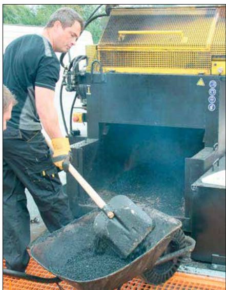
K přípravě asfaltové směsi slouží recyklační zařízení RM 200
